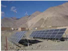
青海30KW送电到乡光伏电站
