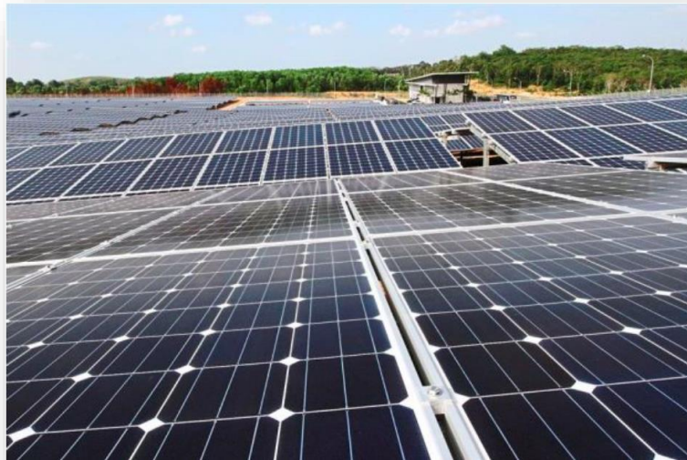
Figure 24: Kompleks Hijau Solar
