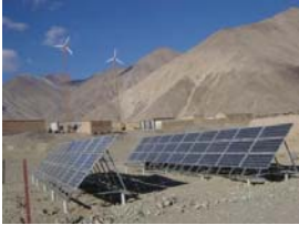
青海30KW送电到乡光伏电站
